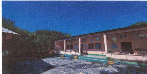
Foto 4: AULAS DONDE SE NECESITA CAMBIO DE LÁMINAS
